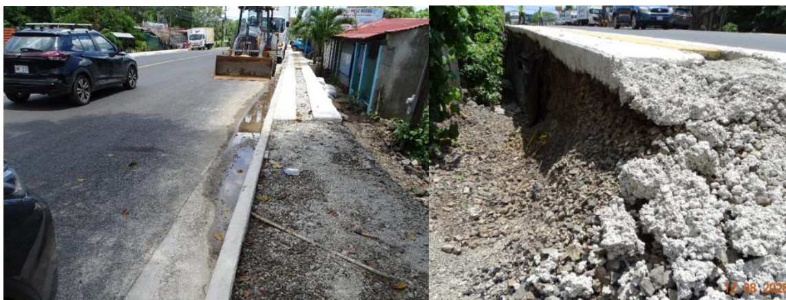
Figura 28. Interrupción de acera y vulnerabilidad a pérdida de soporte en las cercanías del paso transversal. Fotografía del 12 de agosto de 2025. Fuente: LanammeUCR
