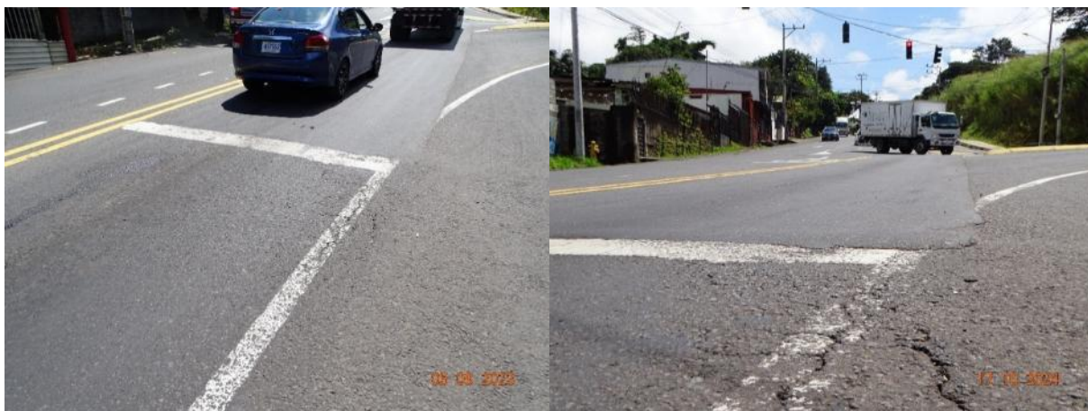
Figura 10. Evolución de agrietamiento por fatiga y deformación permanente. Intersección de acceso de General Cañas hacia Barreal Ruta Nacional N.º 106. Fecha: 5 de septiembre de 2023 – 17 de octubre de 2025. Fuente: LanammeUCR
