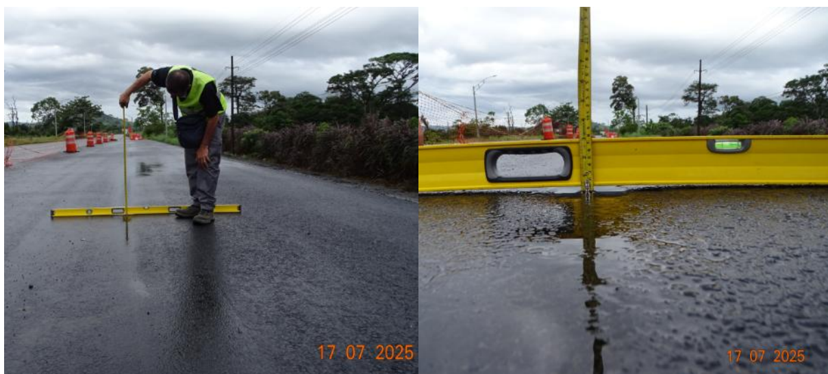
Figura 21. Diferencia de nivel de 1 cm en junta longitudinal cercana a la rampa de salida de la RN 250 hacia RN 04: Fecha 17 de julio de 2025. Fuente: LanammeUCR
