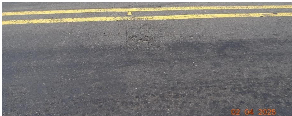
Figura 11. Agrietamiento, deformación permanente y desprendimiento. Intersección de acceso de General Cañas hacia Barreal Ruta Nacional N.º 106. Fecha: 2 de abril de 2025. Fuente: LanammeUCR
