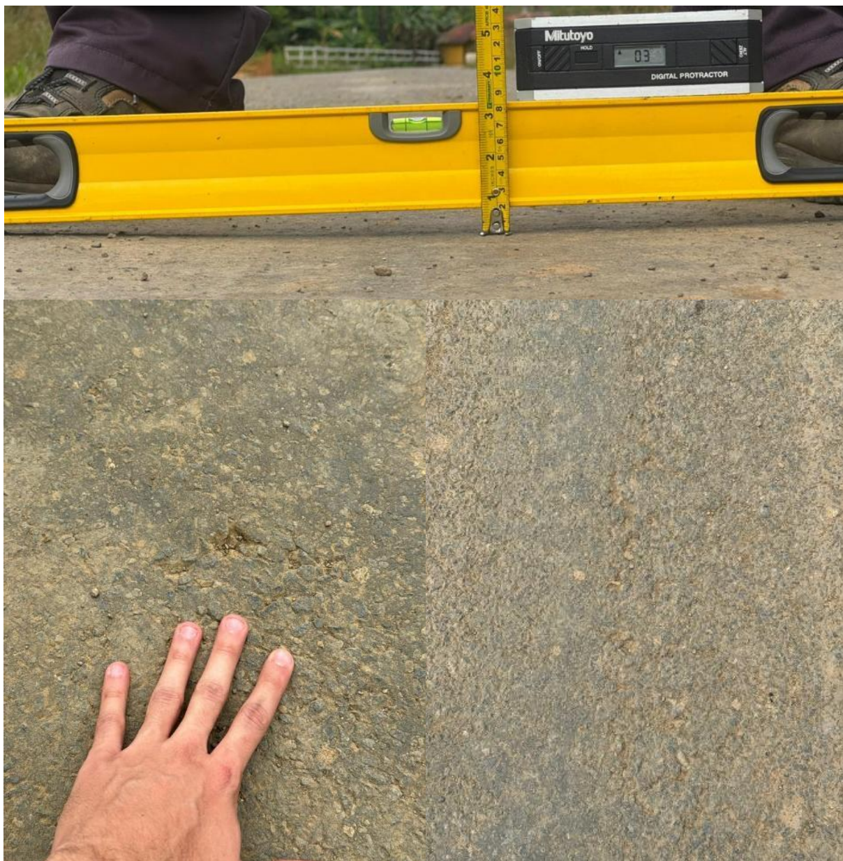
Figura 16. Deformaciones en el centro de la superficie de rueda ubicado en las coordenadas Lat: 10.5000; Long: -84.3729. Ruta Nacional N.º 751. Fecha: 15 de enero de 2025. Fuente: LanammeUCR
