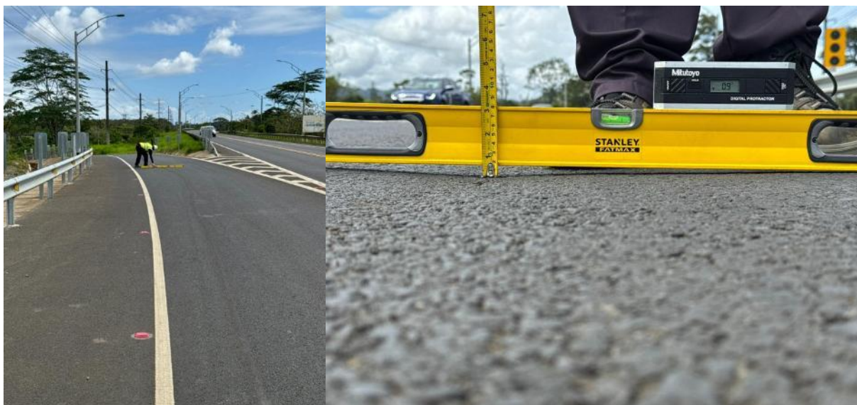
Figura 22. Diferencia de nivel de 1.5 cm en la junta longitudinal cercana a la rampa de salida de la RN 250 hacia la RN04. Registro del 15 de enero de 2025. Fuente: LanammeUCR
