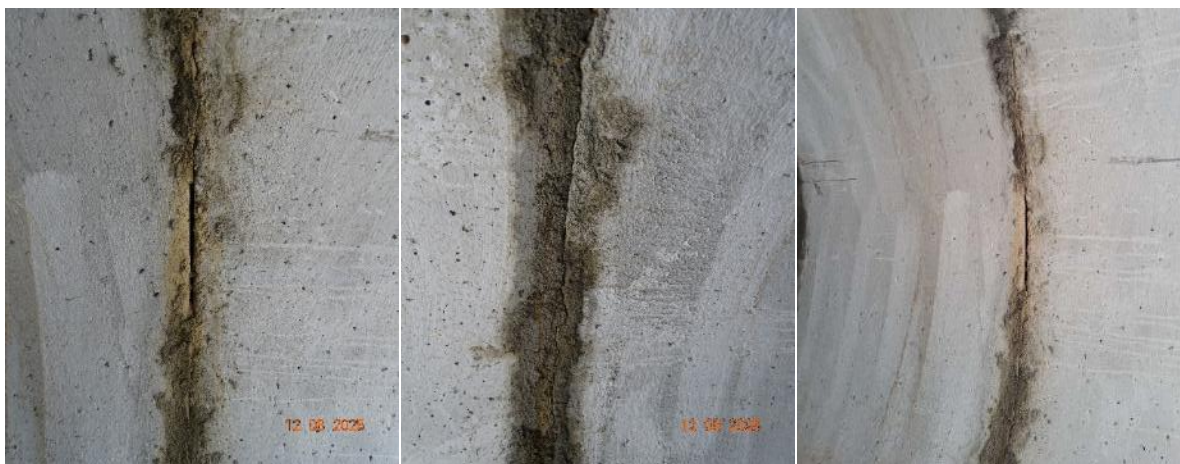
Figura 34. Desprendimiento de unión con mortero en tuberías de paso transversal. Fotografía del 12 de agosto de 2025. Fuente: LanammeUCR
