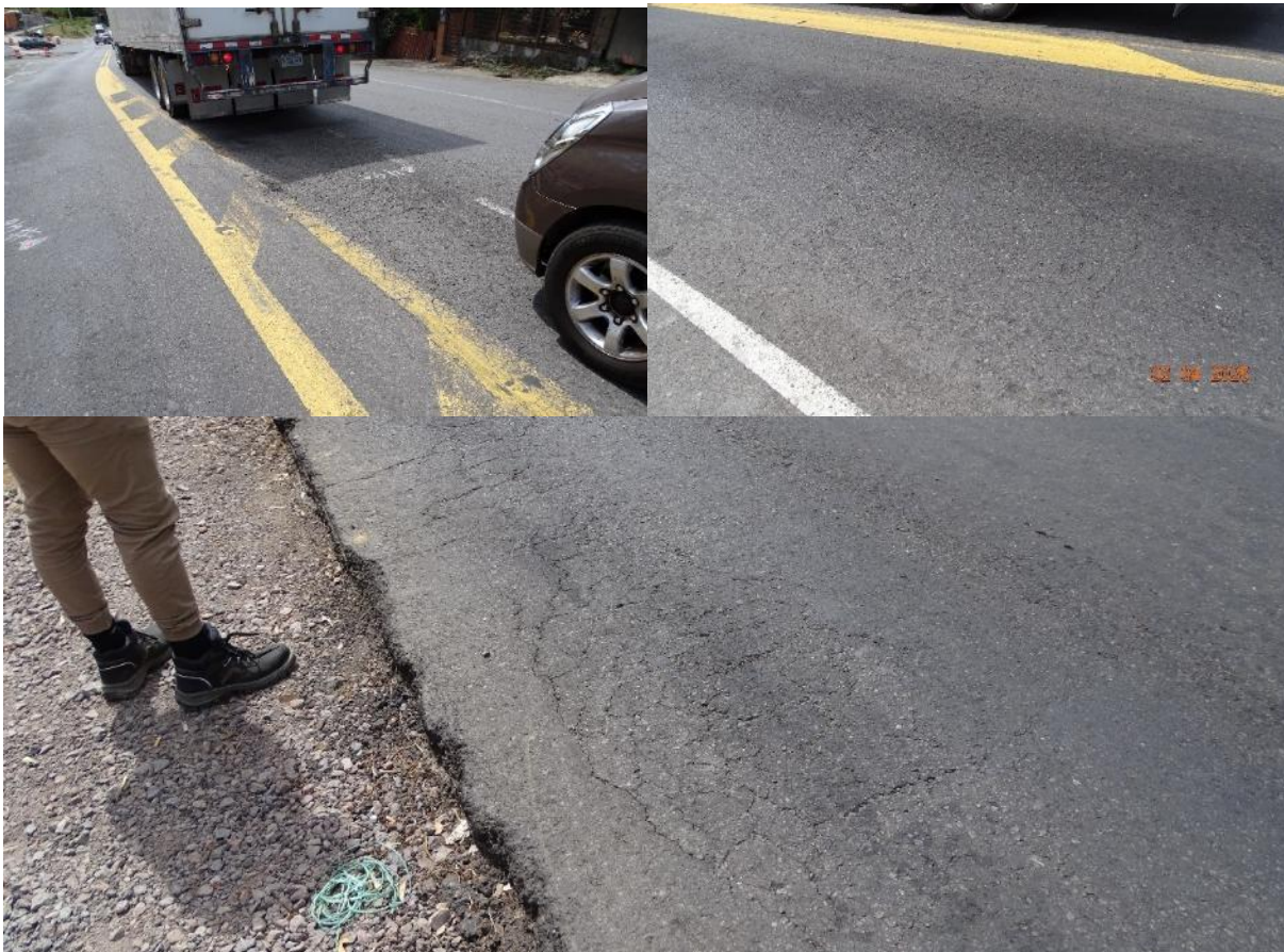
Figura 12. Agrietamiento por fatiga severo. Intersección de acceso de General Cañas hacia Lagunilla Ruta Nacional N.º 106. Fecha: 2 de abril de 2025. Fuente: LanammeUCR
