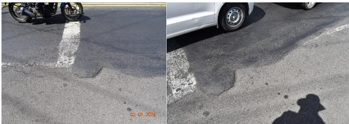
Figura 13. Exudación y deformación permanente. Intersección de acceso de General Cañas hacia Barreal Ruta Nacional N.º 106. Fecha: 2 de abril de 2025. Fuente: LanammeUCR
