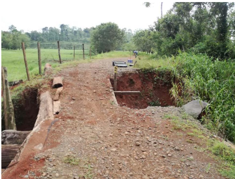
Fotografía 1. Puente sobre río Purgatorio, camino 2-14-0109, luego del evento.
