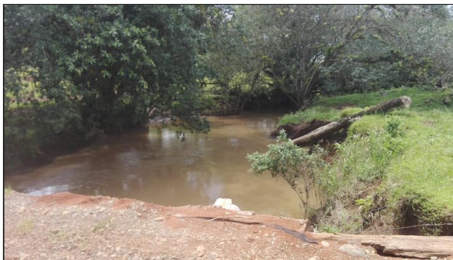
Fotografía 2. Puente sobre río Purgatorio, camino 2-14-109 luego de los eventos.
